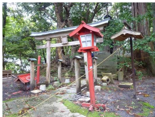
愛宕神社の参道。危険で通行ができない状態
