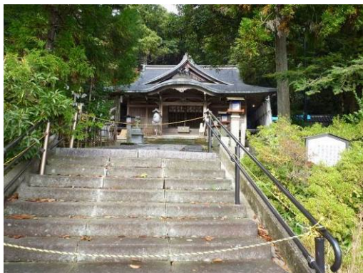
隆起し、危険のため通れない御本殿への階段
