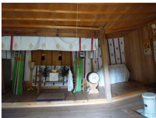
御本殿内部は傾き、危険な状態となっている
